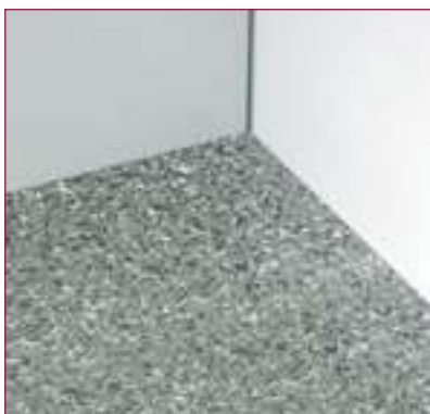
Die Polyurethan-Bodenbeschichtung ist besonders elastisch und fugenlos, somit leicht zu reinigen
